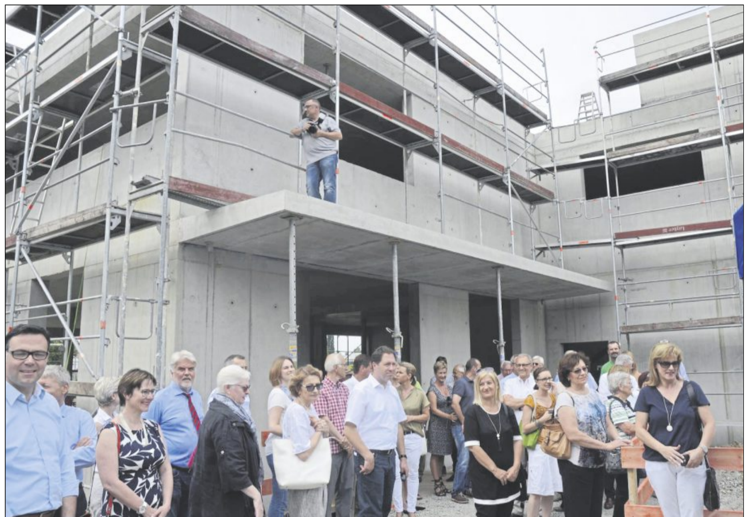
Sportparkrohbau beim Wunnebad: Zum Richtfest am Freitag versammelten sich: Unterstützer, SV-Mitglieder, Baufachleute, Gemeinderäte, Oberbürgermeister, Landtagsabgeordnete und mehr. Bilder: Schmitzer
