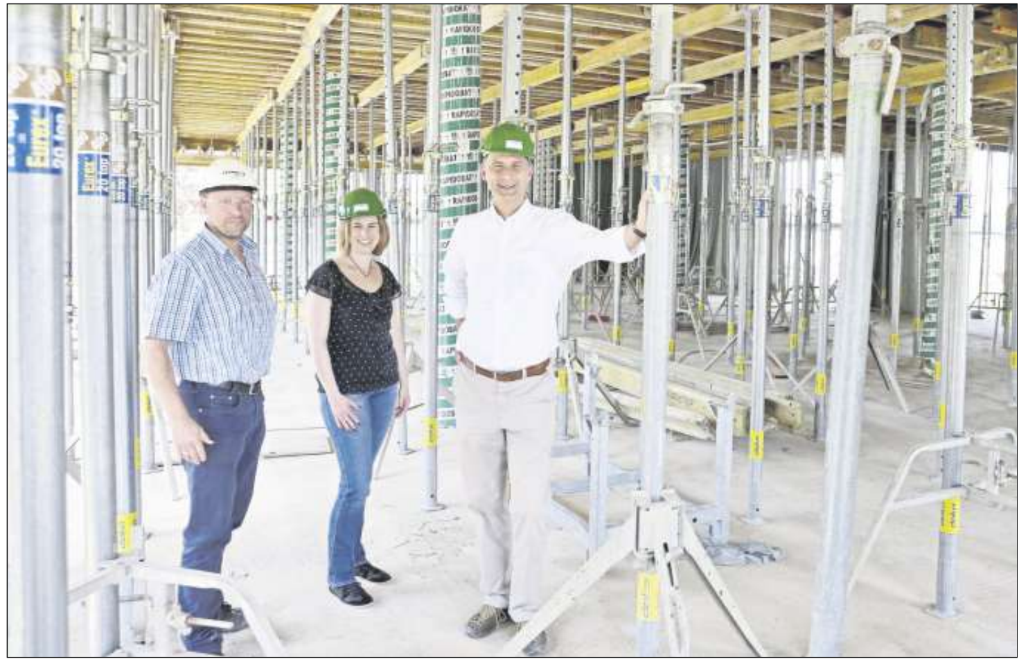
Bauleiter Martin Trinklein, SV-Geschäftsführerin Claudia Brähler und SV-Vorsitzender Hans-Jürgen Will im Rohbau des „Sportparks“.
